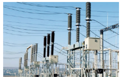
Освещение электрической подстанции энергомоста в Крыму, станица Тамань, 2016 г.
