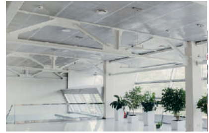
Освещение офисного помещения, г. Челябинск, 2017 г.
